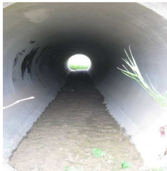
Рисунок 3.8 – Песчано-илистые отложения в правосторонней трубе
